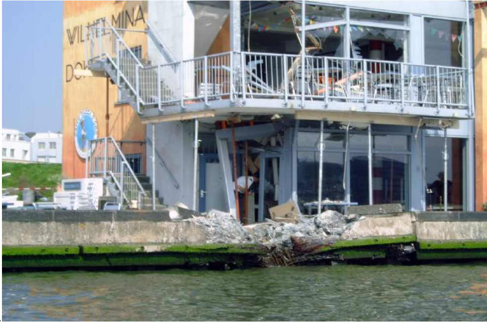
Afbeelding 9 Schade Restaurant Wilhelminadok (Bron Rijkswaterstaat)
